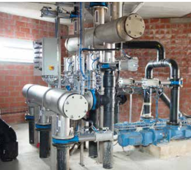
Exemple d'unité de méthanisation installée dans une exploitation agricole.
