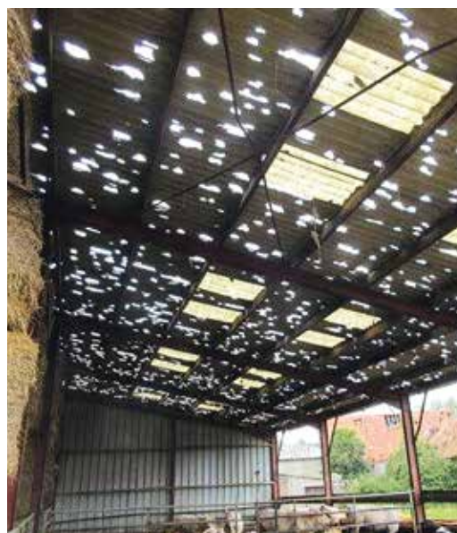
La grêle peut fortement endommager les installations agricoles.
